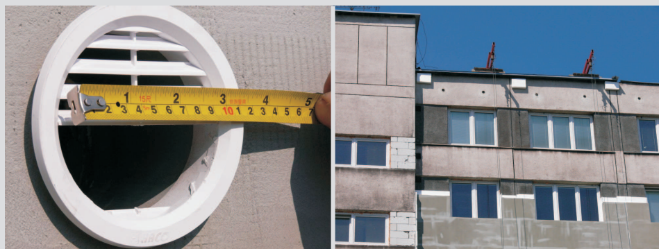
foto č. 1 nezasklepené vletové štěrby
